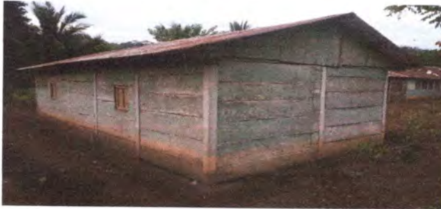
Foto1: laminas en mal estado y deteriorado
