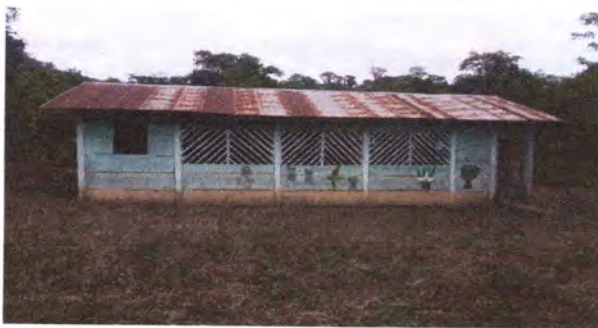
Foto 3: Pared de madera y puerta ya deteriorado.
